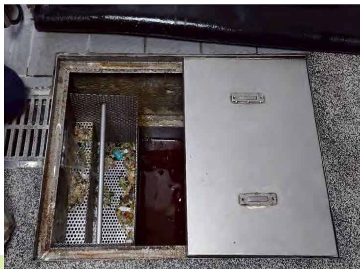
油脂截留設施
