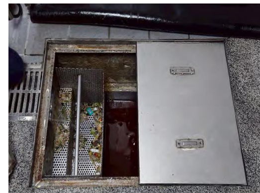
油脂截留設施
